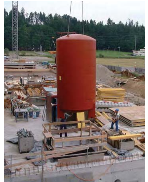
Pufferspeicher für Dienstleistungsgebäude
